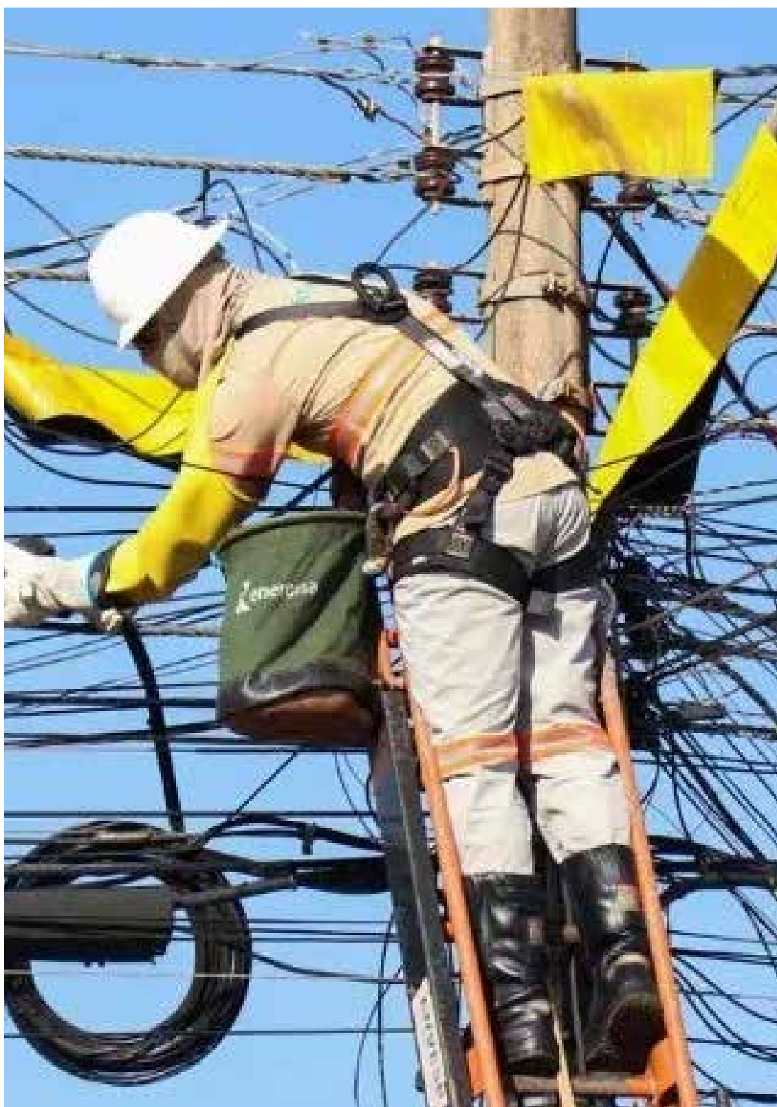
Durante as fiscalizações, foram emitidas 780 notificações às operadoras de telecomunicações para corrigir instalações fora dos padrões das normas de ocupação da rede
